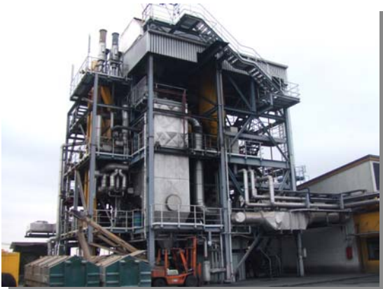
写真：CHP メインプラント
